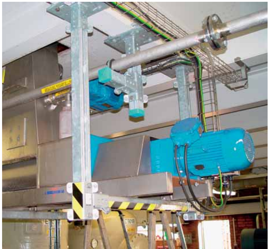
Unterstützung einer Förderschnecke mit Powerclick System 63 Support of a screw conveyor with Powerclick System 63
